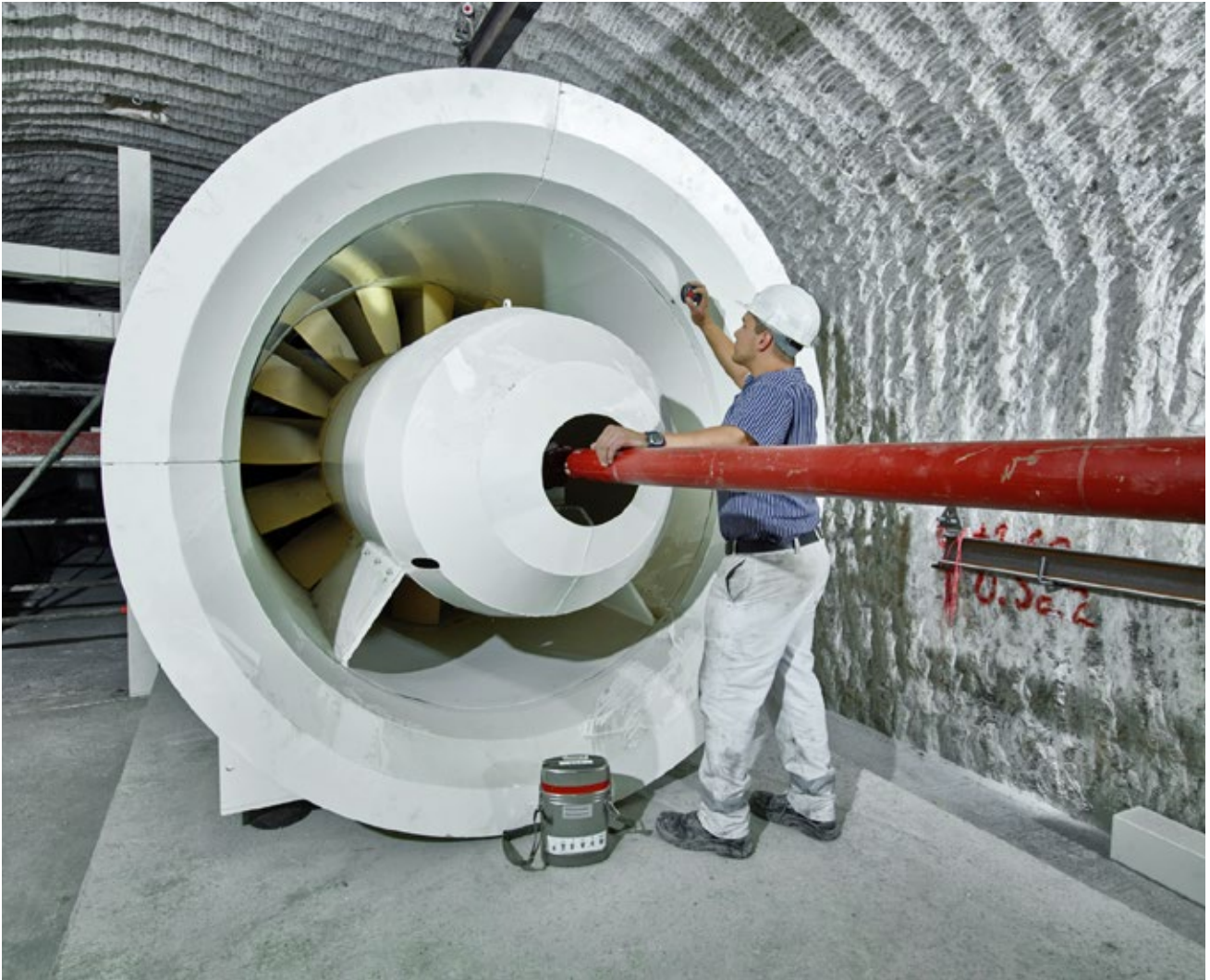
Die „Lunge“ der Schachanlage: Der Hauptgrubenlüfter auf der 490-Meter-Ebene garantiert den Austausch der Luft zwischen unter und über Tage
